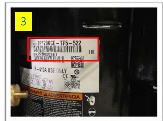
壓縮機外觀與銘牌確認
