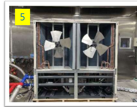
冷凝器外觀與銘牌確認
