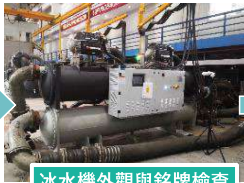
冰水機外觀與銘牌檢查
